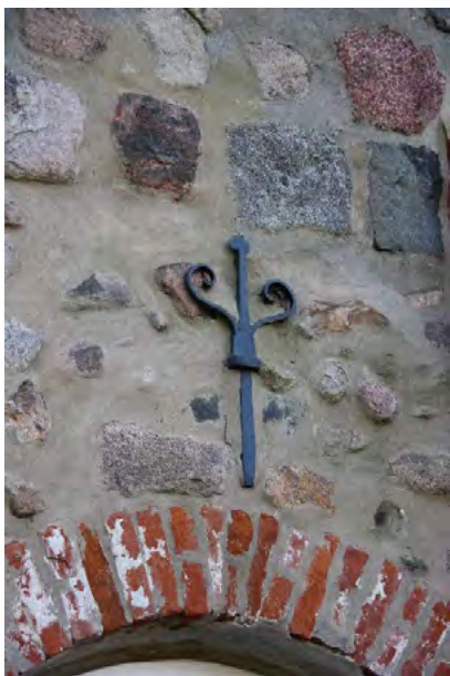
Figura 22 – Âncora de parede na fachada de uma igreja em Hamburgo.
